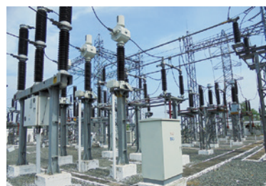
敷地内変電所
